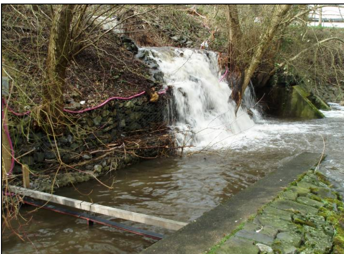
Abb. 20: Uferbruch im Umgehungsgerinne Buchenhofen
