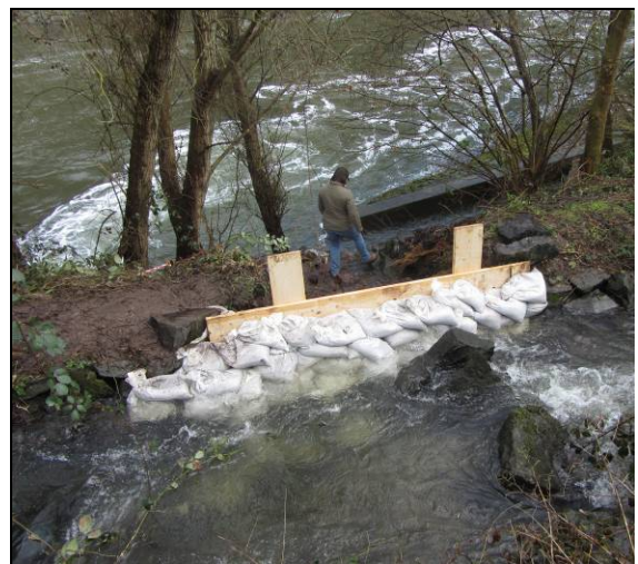
Abb. 21: Provisorische Abdichtung des Uferbruchs durch den Wupperverband
