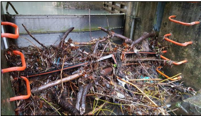
Abb. 18: Durch Verklauung zerstörte die PE-Antenne 25 am Einlauf in die Fischaufstiegsanlage in Glüder (Foto: Wupperverband)
