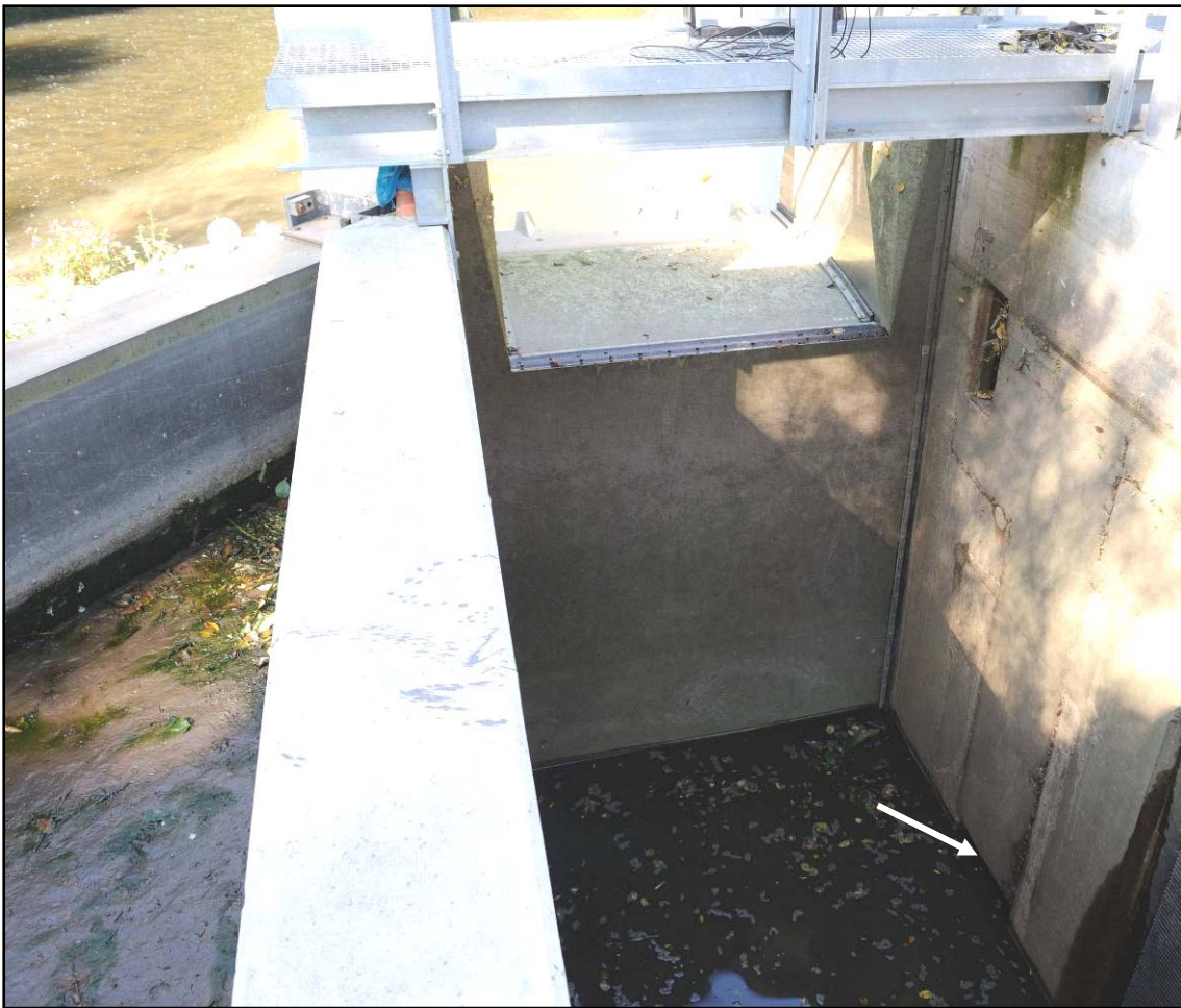
Abb. 61: Selbst bei vollständig entleertem Turbinenobergraben ragt allenfalls die Oberkante des sohlennahen Bypasses aus dem Sediment und/oder Sickerwasser
